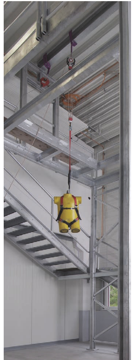
Prüfstand für Absturzsicherung bei MAS
